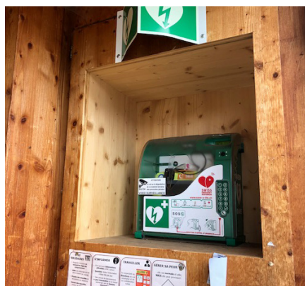
... et celui placé à l'entrée du Proxi.
