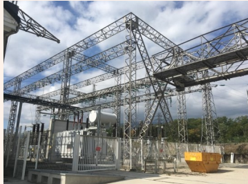
Le poste électrique
